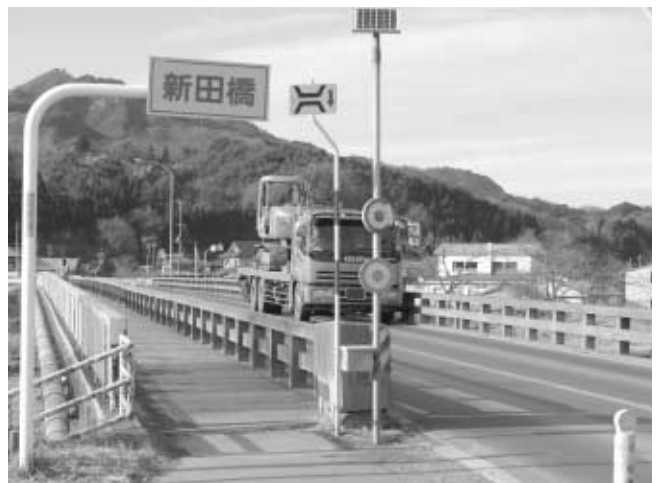
早急な改良が望まれる豊間根新田橋
