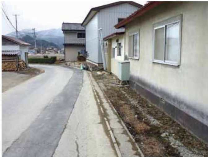
改良が望まれる町道白山・石峠線
