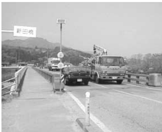
老朽化が著しく早期の架け替 えが望まれる豊間根新田橋
