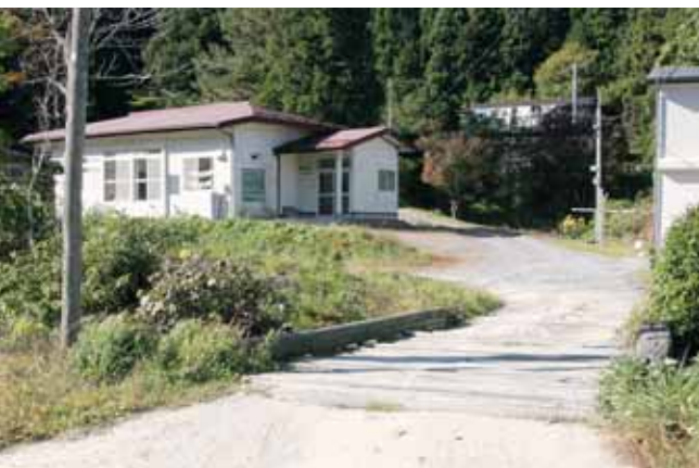
老朽化により改修が望まれている織笠新田集落センター前の橋梁(新田地区)
