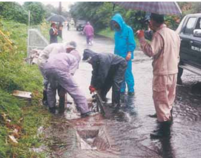
大雨の際、道路が冠水した町道石峠線
