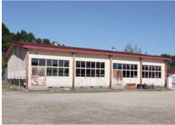
昭和46年の建設から37年が経過し、早期の改築が望まれる山田中学校格技場
