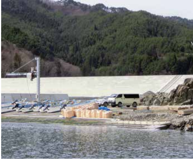
消波ブロックと船揚げ場の一部が被災した
