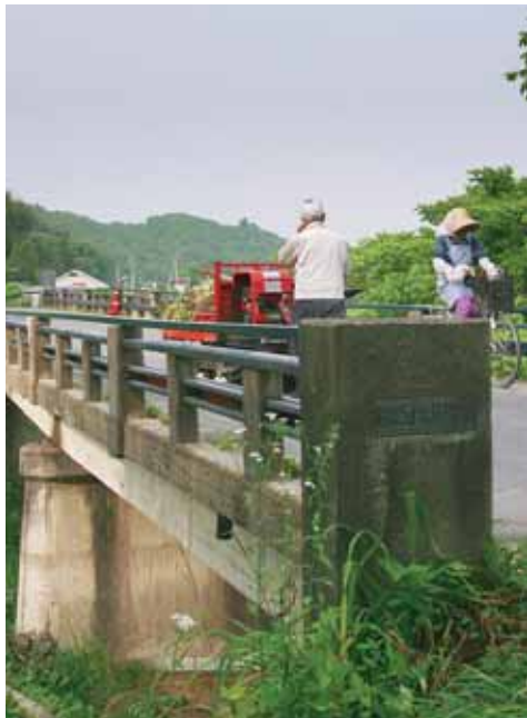
昨年の12月の低気圧による大雨災害で沈下した馬指野橋（約3千万円の事業費で本年度から復旧工事が始まります）
