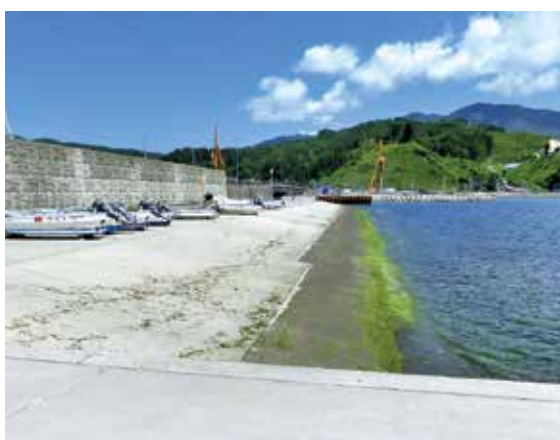
勾配の改良が望まれる北浜船揚場
